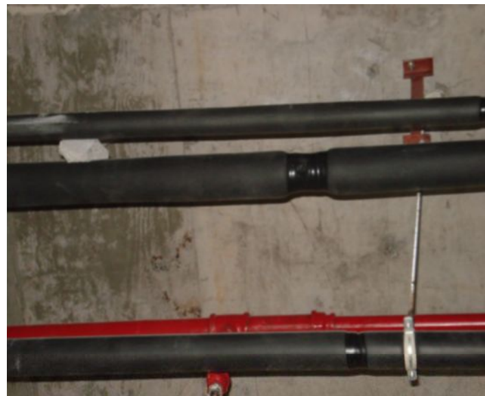
Стыки имеют тонкую теплоизоляцию
