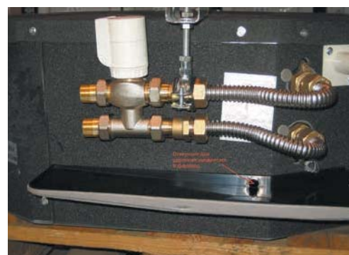
Поддон для сбора конденсата (внешний) и запорно-регулирующий узел смонтированы на кассетном фанкойле
