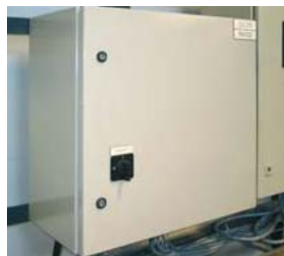
Силовой шкаф РК100
