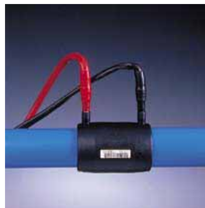
Рис. 37 11. Проверить глубину вставки. Если зачищенная область выглядывает из муфты, следует убедиться, вставлена ли труба до конца в муфту
