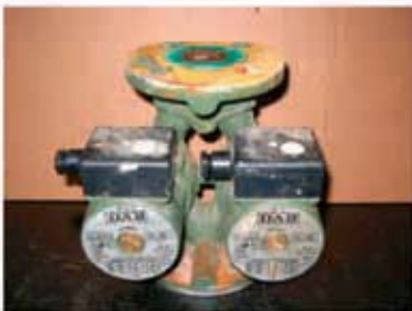
Состояние двойного насоса
