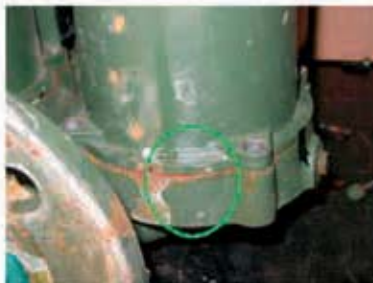
Утечка из отвода конденсата
