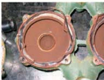
Причина утечки из отвода конденсата. Повреждение уплотнения корпуса
