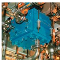
Подвешенный Компаблок в системе конденсации
