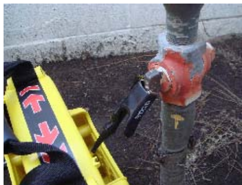
Рисунок 7 – Подводящий провод, подсоединенный к определяемому проводнику
