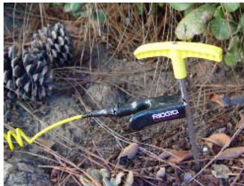
Рисунок 6 – Зажим подводящего провода, подсоединенный к заземляющему стержню
