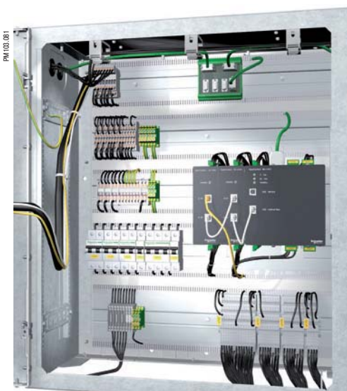
Шкаф низкого напряжения с контроллером GemControl
