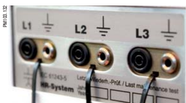
Гнёзда для индикаторов неинтегрированной системы контроля напряжения трёх фаз
