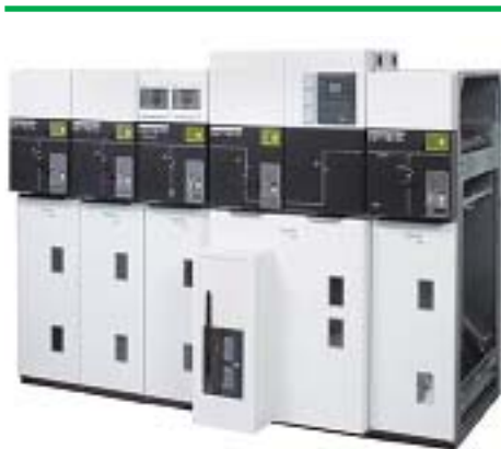
Рис. В36. Модульное распределительное устройство в металлическом корпусе
