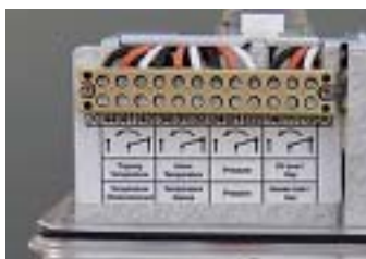
Рис. В18а. Контакты реле защиты трансформатора DGPT (со снятой крышкой)
