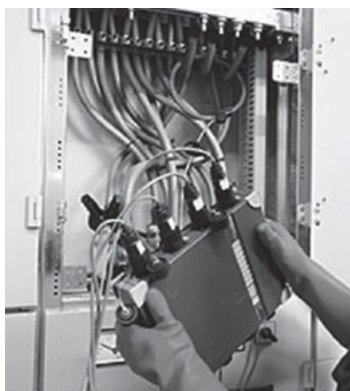
Рис. М11. Установка цифрового записывающего устройства качества электроэнергии в шкафу
