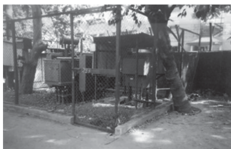
Рис. В54. Подстанция наружной установки без корпуса
