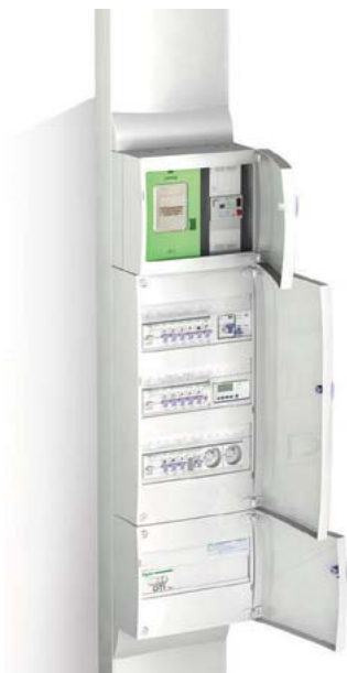
Рис. Q4. Контрольно-распределительный щит
