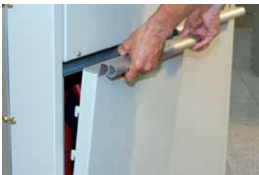
Открытие нижней крышки отсека кабельных присоединений после отпирания
