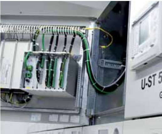
Низковольтный шкаф с встроенными в дверь приборами
