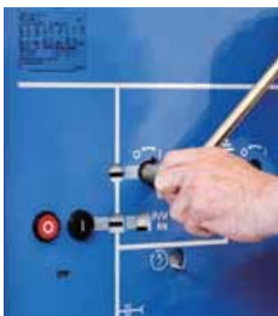
Механическое обслуживание разъединителя
