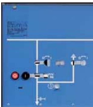
Панель управления функционального блока силового выключателя
