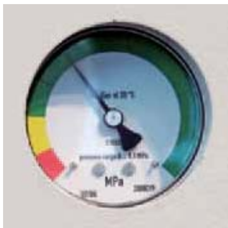
Манометр как индикатор эксплуатационной готовности (базовое исполнение)
