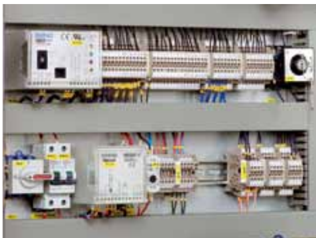
Оборудование безопасности системы BMS.
