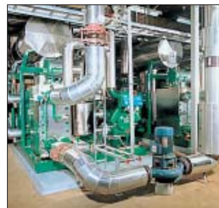
Рис. 2. Аммиачный испаритель/конденсатор AlfaRex TM10-B в холодильной установке, работающей в режиме теплового насоса, установленной в Датском научно-исследовательском институте. Данная система была спроектирована и смонтирована компанией Sabroe.
