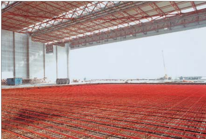
Рис. 9-1 Напольное отопление в промышленном цехе
