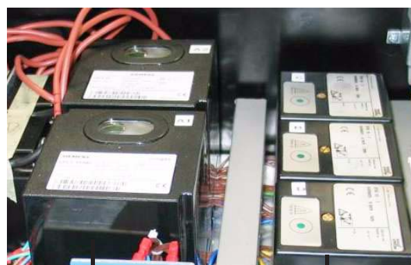
(A1) SIEMENS LFL... (A2) SIEMENS LAL..
