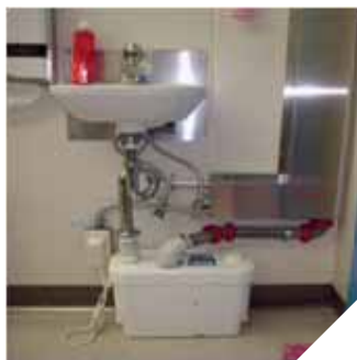
Sanivite, установленный в комнате 2
