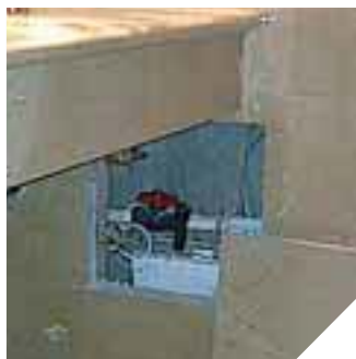
Sanipack установлен за стеной с монтажным люком
