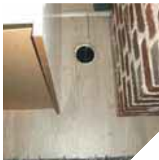
Дренажная труба, проведенная из подвала на кухню
