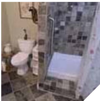
Ванная комната на цокольном этаже, подсоединенная к насосу Sanipro, скрытому в стене
