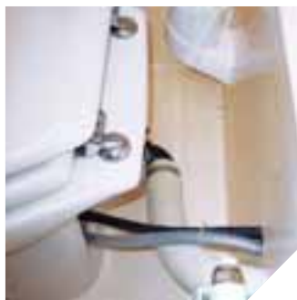
Вид на соединения унитаза системы Sanimarin
