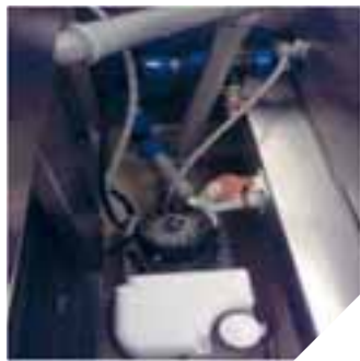
Sanicomp, установленный за плитой
