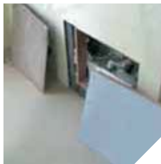
Sanipack установлен за стеной
