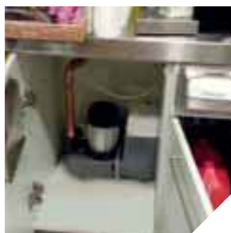
Sanicom, установленный в шкафу
