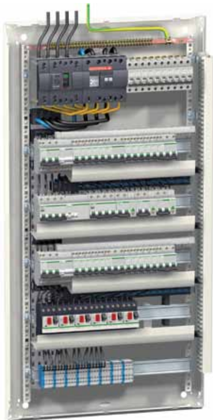
NG160 в модульном шкафу
