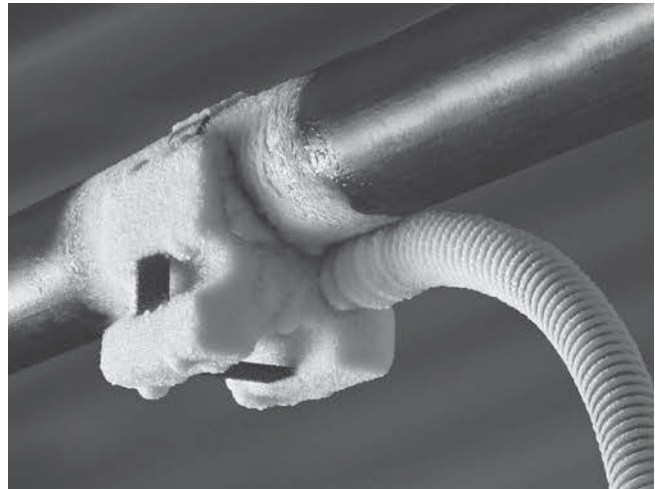
Figur 9 – Frysehoved fastfrosset på rør
