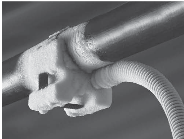
Slika 9 – Zamrzovalna glava zamrznjena na cev
