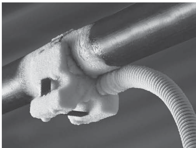
Rys. 9 – Głowica zamrażająca przymarznięta do rury
