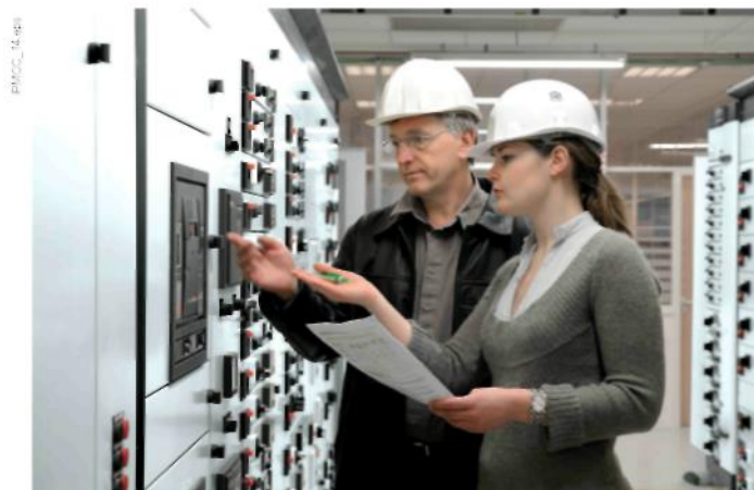
Щит управления двигателем (MCC)
