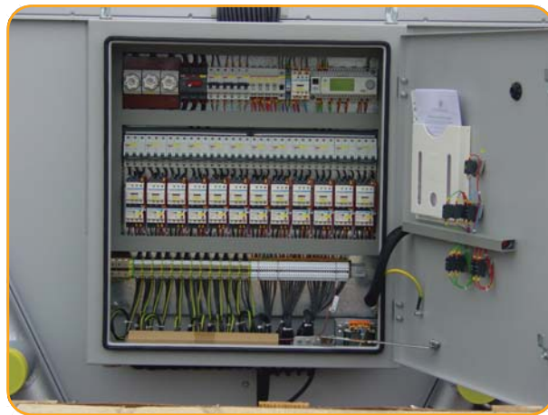
Панель управления с шаговым контроллером и интегрированным управлением адиабатическим процессом
