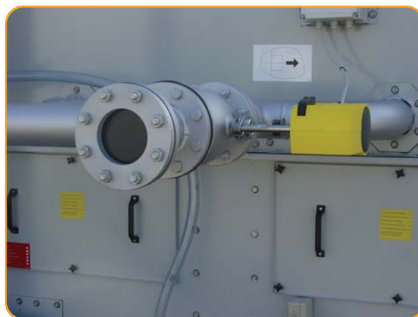
Блок управления расходом воды
