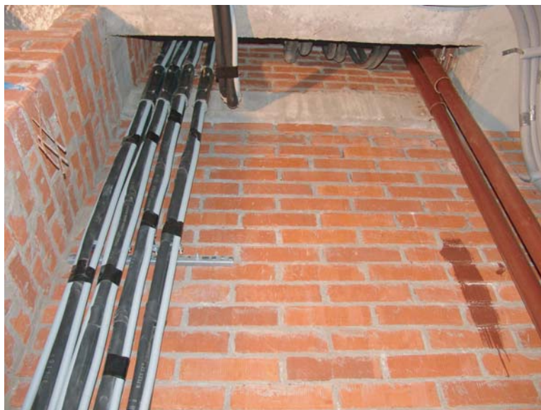
Магистральные участки фреоновых проводов в вертикальных шахтах.
