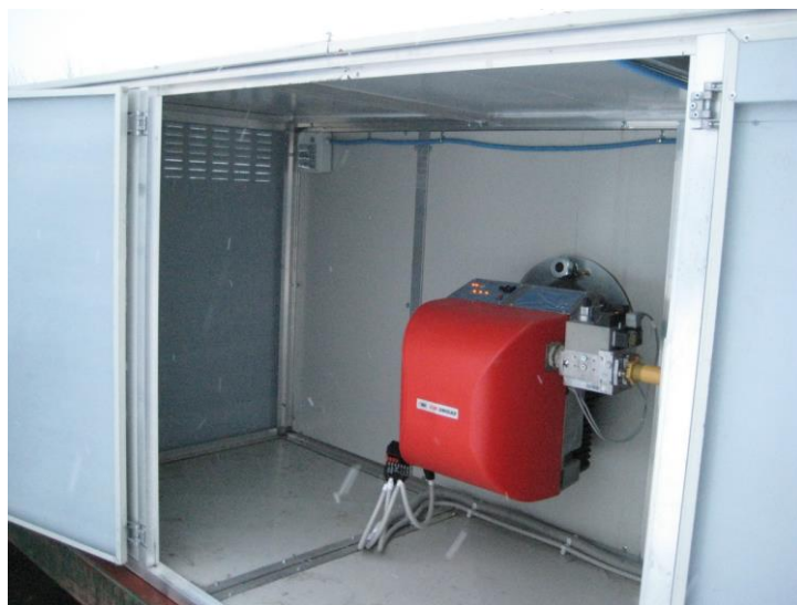
Стандартный "отсек горелки" GEO375. В эксплуатации с 2008 года, г. Пермь.
