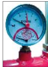
Термоманометр на выходе котла
