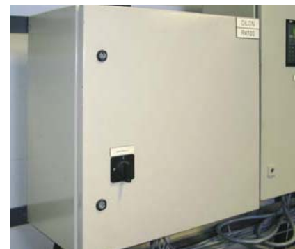
Силовой шкаф RK100
