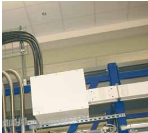
Шинопровод Canalis KS и спринклер
