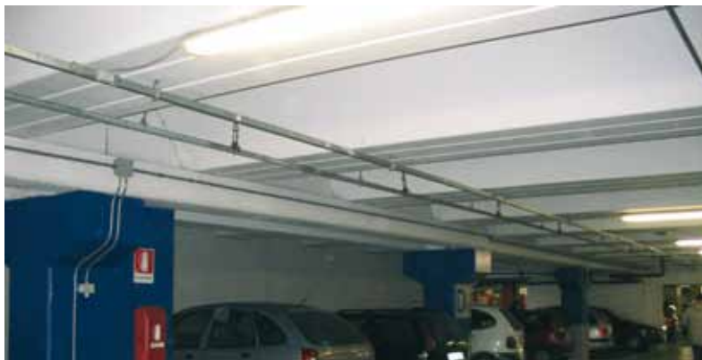
Шинопровод Canalis KVA со светильниками и спринклерами
