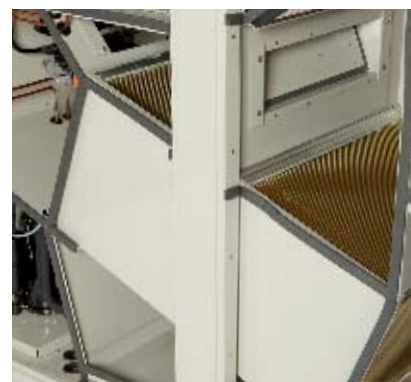
Высокоэффективные рекуператоры выполнены из алюминия с эпоксидным покрытием, предохраняя их от воздействия хлорсодержащего воздуха бассейна.
