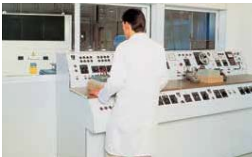
Пульт управления испытательного стенда
