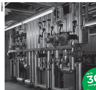
Управление насосной станцией
