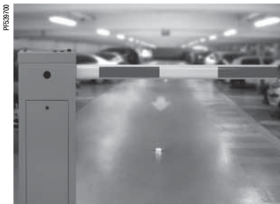
Шлагбаум, управляемый ПЧ ATV 12
