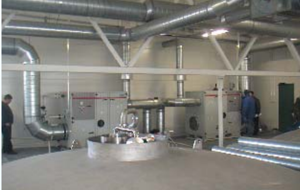
Осушители DT 5000 Завод «Балтика-Ярославль»
