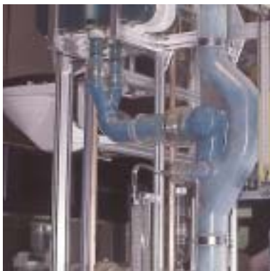
Стенд для гидроиспытаний
