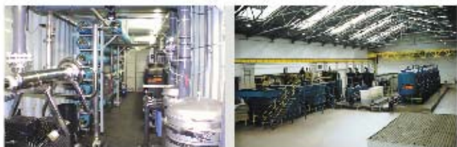
Станция опреснения морской воды на греческом острове Итака, проток воды 800 м³/час.
