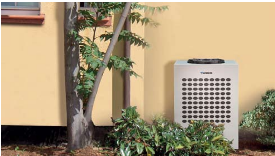
Внешний блок воздушного теплового насоса
