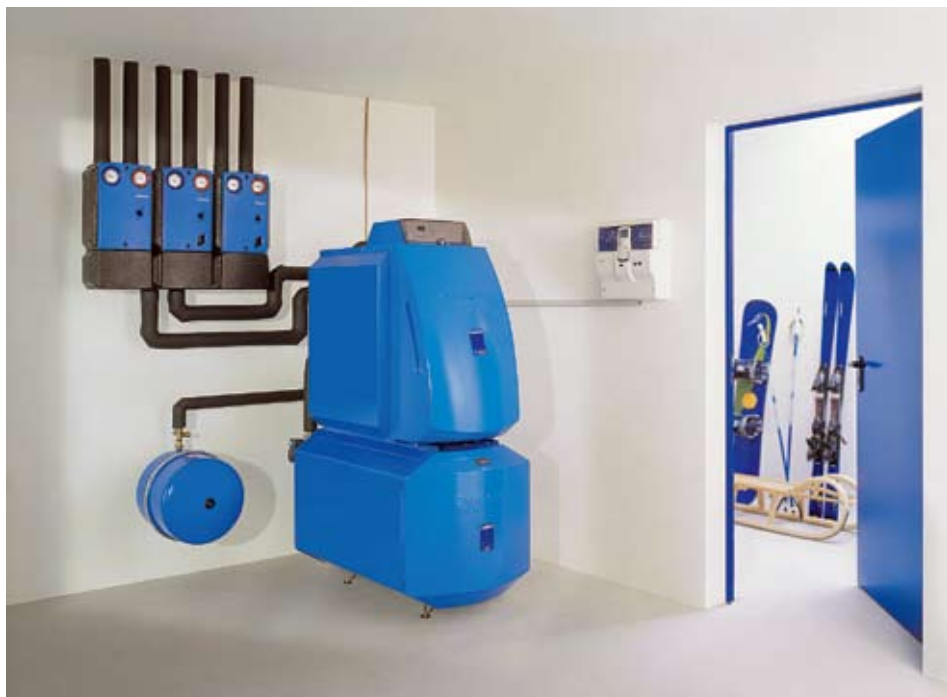
Напольный котел с бойлером ГВС
