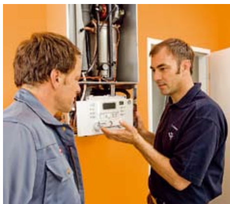
Программирование режимов работы котла
